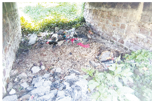
项城市高寺镇001乡道张老家村南桥下存在堆积大量杂物现象
